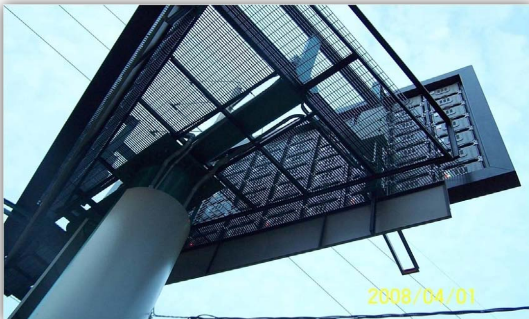
LED MAX na pôvodne statickom billboarde
